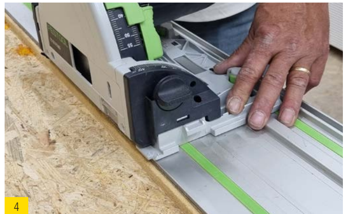
4 Scier la cale d'étanchéité et les deux extrémités de cale d'étanchéité au niveau du bord avant à la profondeur souhaitée.
