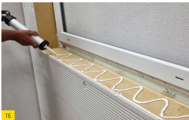
16 Appliquer best wood FDM WALL en serpentín sur la tablette de fenêtre.
