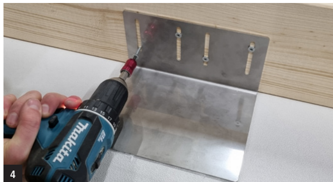
4 Visser l'équerre dans la traverse. Remarques: prévoir une équerre de renfort au droit d'un raccord entre panneaux
