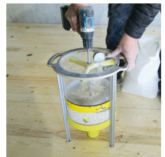
Mit Hilfe eines Akkuschaubers die Schüttung mit niedriger Drehzahl in die CLT BOX – DECKE FS einbringen
