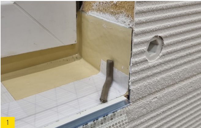
1 Dichtschnur im vorderen Bereich unter 45° auf 2. Dichtebene bis an das Putzabschlussprofil Fensterbank legen.
