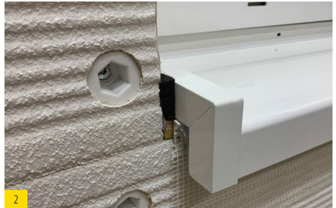
2 Fensterbank montieren. Fensterbankendstück und Putzabschlussprofil müssen bündig sein. Fugendichtband auf Fensterbankendstück aufbringen.
