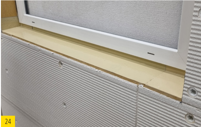
Fertig verklebte und eingepasste Dichtebene wird nun an den Stoßfugen abgedichtet und das Putzabschlussprofil angebracht.
