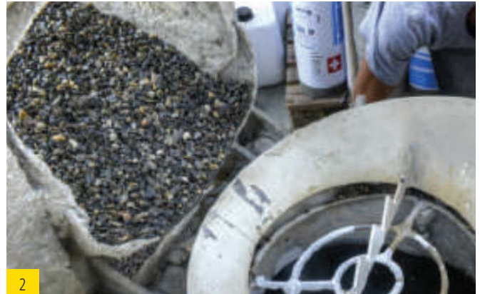
Anmischen des Estrichs in der Estrichpumpe. Je m^3 Splitt (Körnung 5/8) werden 30kg Bindemittel benötigt.
