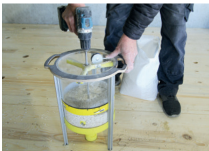
Mit Hilfe eines Akkuschaubers die Schüttung in die CLT BOX – DECKE FS einbringen
